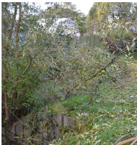
Splav před vyčištěním
